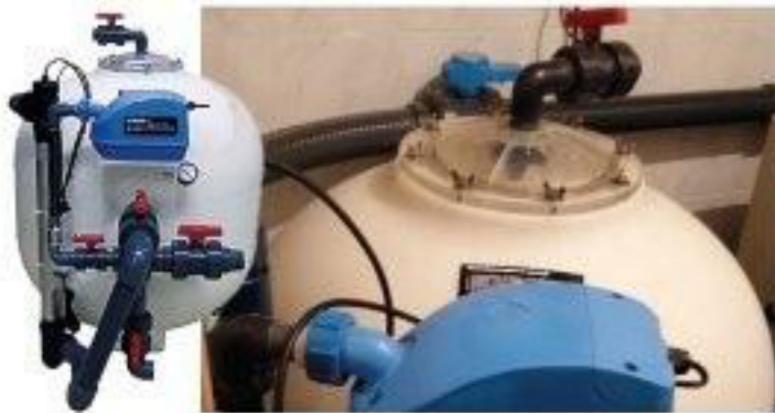
Schmutz und Biofilter in einem
